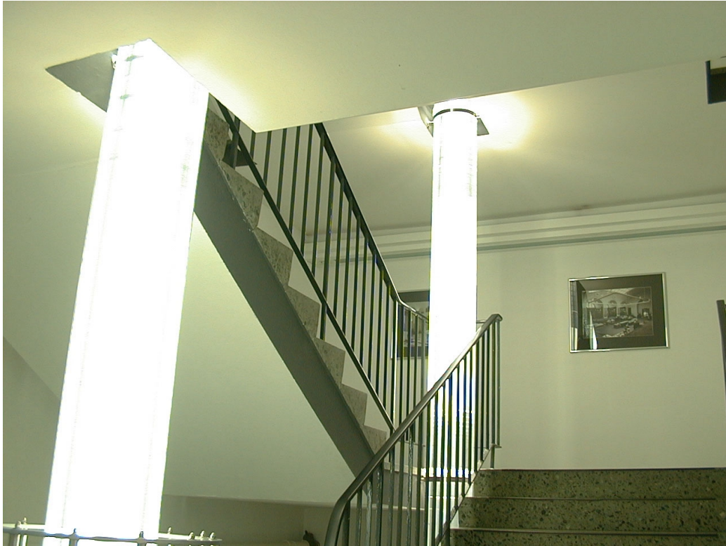
Abb. 4 Hohllichtleiter im Treppenhaus bei Sonnenlichteinspeisung
