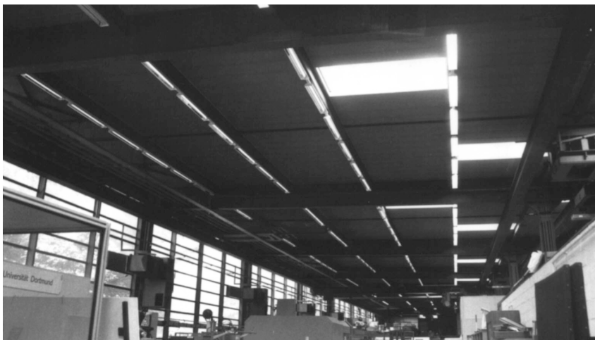
Abbildung 4: Hallenansicht nach Umbauarbeiten, Lichtbänder 1 bis 3 in Fensternähe tageslichtabhängig geregelt, Lichtband 4 ungeregelt
